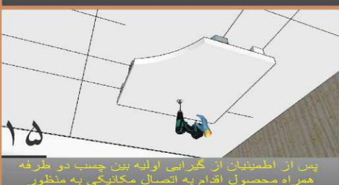
پس از اطمینان از گیرایی اولیه بین چسب دو طرفه همراه محصول اقدام به اتصال مکانیکی به منظور تقویت و ایجاد یک اتصال موقت تا زمان گیرایی نهایی توسط چسب چوب نمایید. توجه داشته باشید به سبب وجود سیم های پنهان در سقف های بتونی و در صورت کنترل نکردن توسط دستیار می و همچنین سایر نکات در محل اتصال مکانیکی نهایتاً یک ال ای دی نقطه اتصال به سقف بتونی می ماند و چنین افرادی محصول جدیدان نمی ماند. توجه داشته باشید به منظور گیرایی چسب دو طرفه سقف عاری از هر گونه رطوبت ناشی از روغن، آب و یا گرد و غبار باشد.
