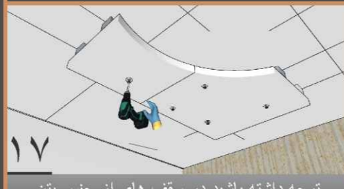
توجه داشته باشید در سقف های از جنس بتن برای اتصال موقت تا گیرایی کامل چسب از پیچ و رول پلاک استفاده نمایید. همچنین در سقف های معمولی به منظور اتصال قویتر پیچ ها را با کمی زاویه به سقف اتصال دهید.
